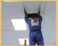
Faux Plafond en laine de Roche
